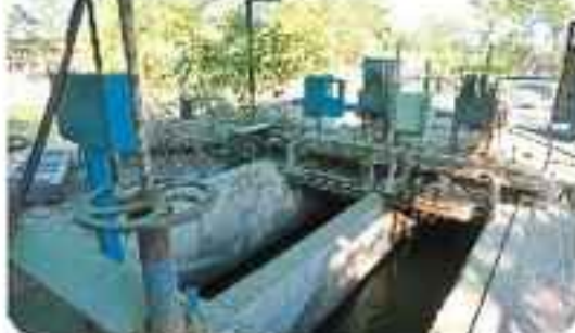
नांदड़ी सीवरेज ट्रीटमेंट प्लांट में बंद पड़ी मशीनें।
